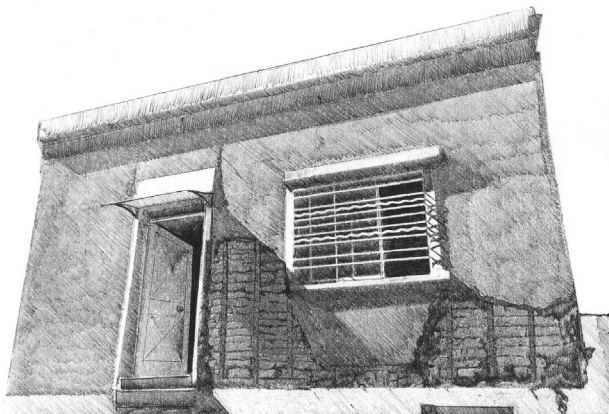
Fig.20: Desprendimiento de revestimiento de cemento
